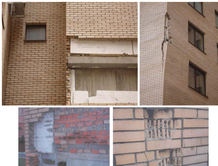
Рис. 2. Влияние циклов замораживания и оттаивания на температурно-влажностные деформации, приводящие к разрушению ограждающих конструкций.
